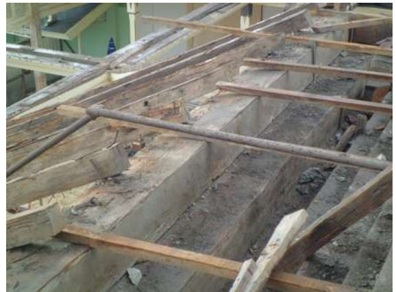
Gambar 6. Gandamaru yang tidak terpasang pada balok tumpangsari
