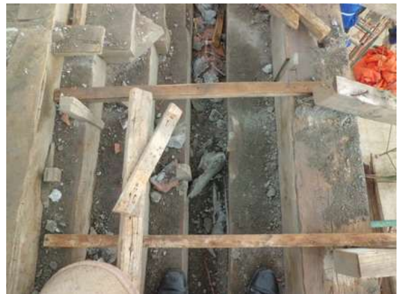
Gambar 7. Gandamaru yang tidak berfungsi dengan baik (dimensi kecil)
