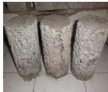
Gambar 7. Kerusakan beton dengan split Merapi faktor air semen 0.5
